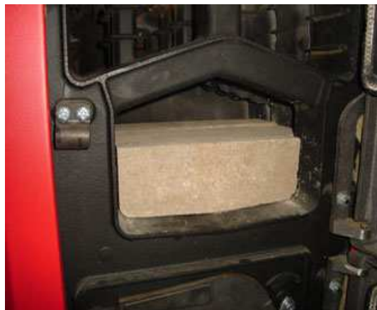
Rys. 12. Umieszczenie katalizatora ceramicznego na półkach wymiennika kotła LING COMBI.
